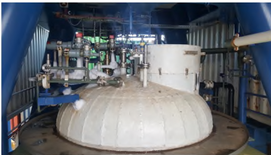
Рисунок 4 - Домна (верхняя часть) танка запаса и хранения СПГ на борту судна
