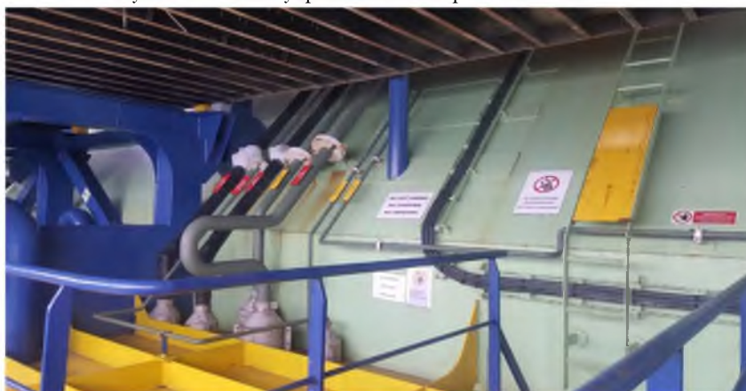
Рисунок 3 - Боковая часть обшивки танка хранения СПГ на борту судна
