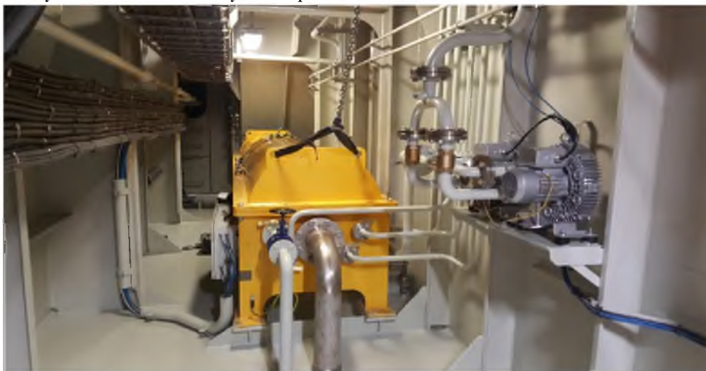
Рисунок 7 - Блок газовых клапанов (GVU - Gas Valve Unit) - последний рубеж перед подводом газа к главному двигателю
