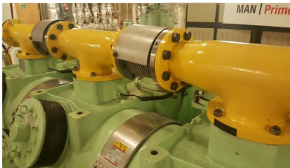
Рисунок 8 - Газовый трубопровод главного двигателя, оборудованный электромагнитными клапанами
